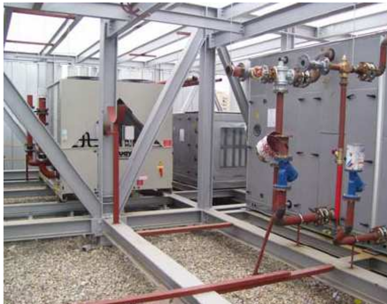
Instalaciones de climatización en cubierta del edificio
